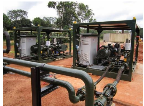
Unités de pompage.
