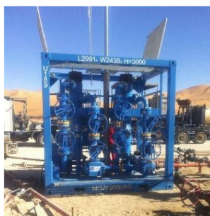
Filtre à sable.
