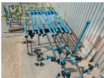
Éléments de tuyauterie.
