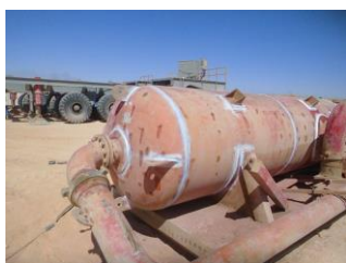
Épurateur de gaz.
